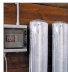
Impianto elettrico Electric system
